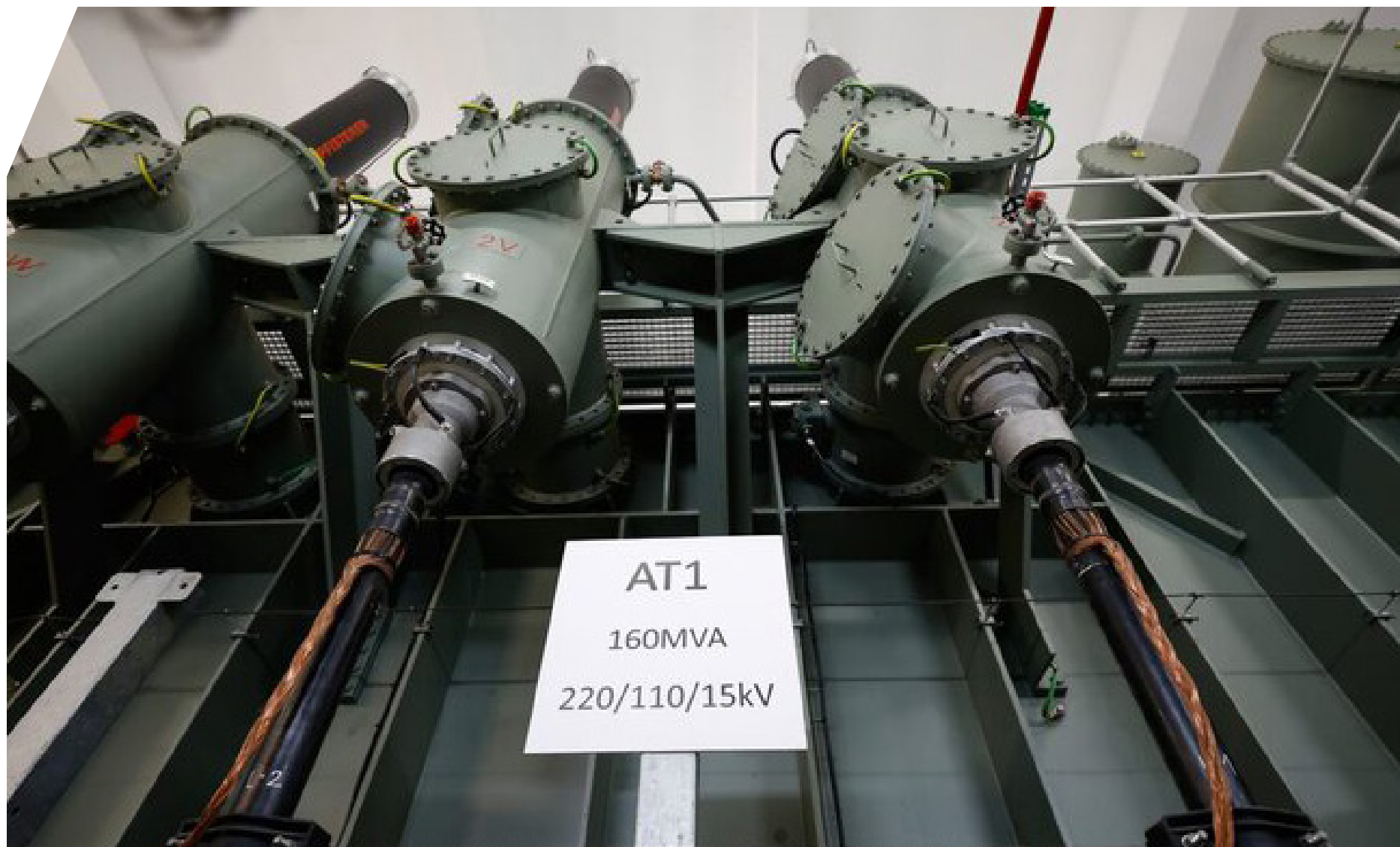
Stoen Operator, Stacja elektroenergetyczna Towarowa
