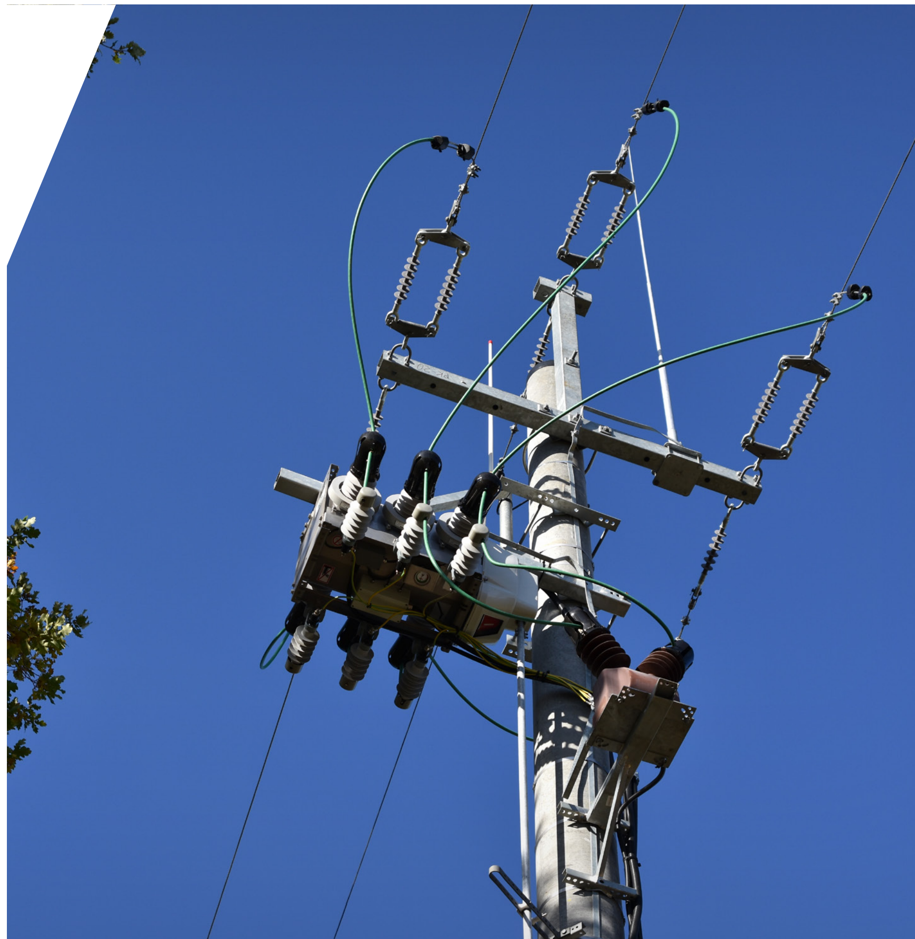
Energa-Operator, Łącznik zdalnie sterowany z monitorowaniem parametrów pracy sieci SN i wykrywaniem zwarcć
