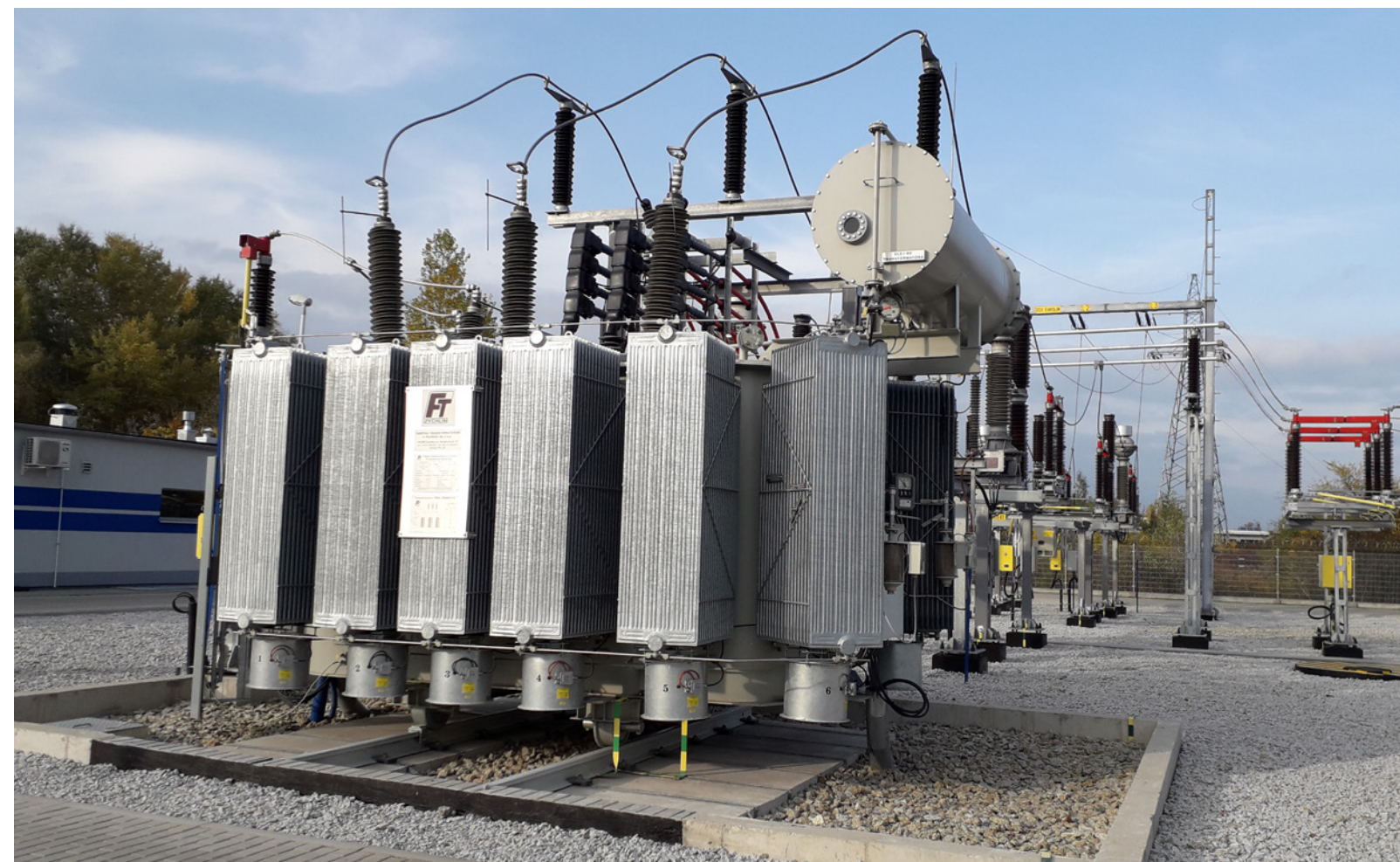
Enea Operator, GPZ Główna w Poznaniu
