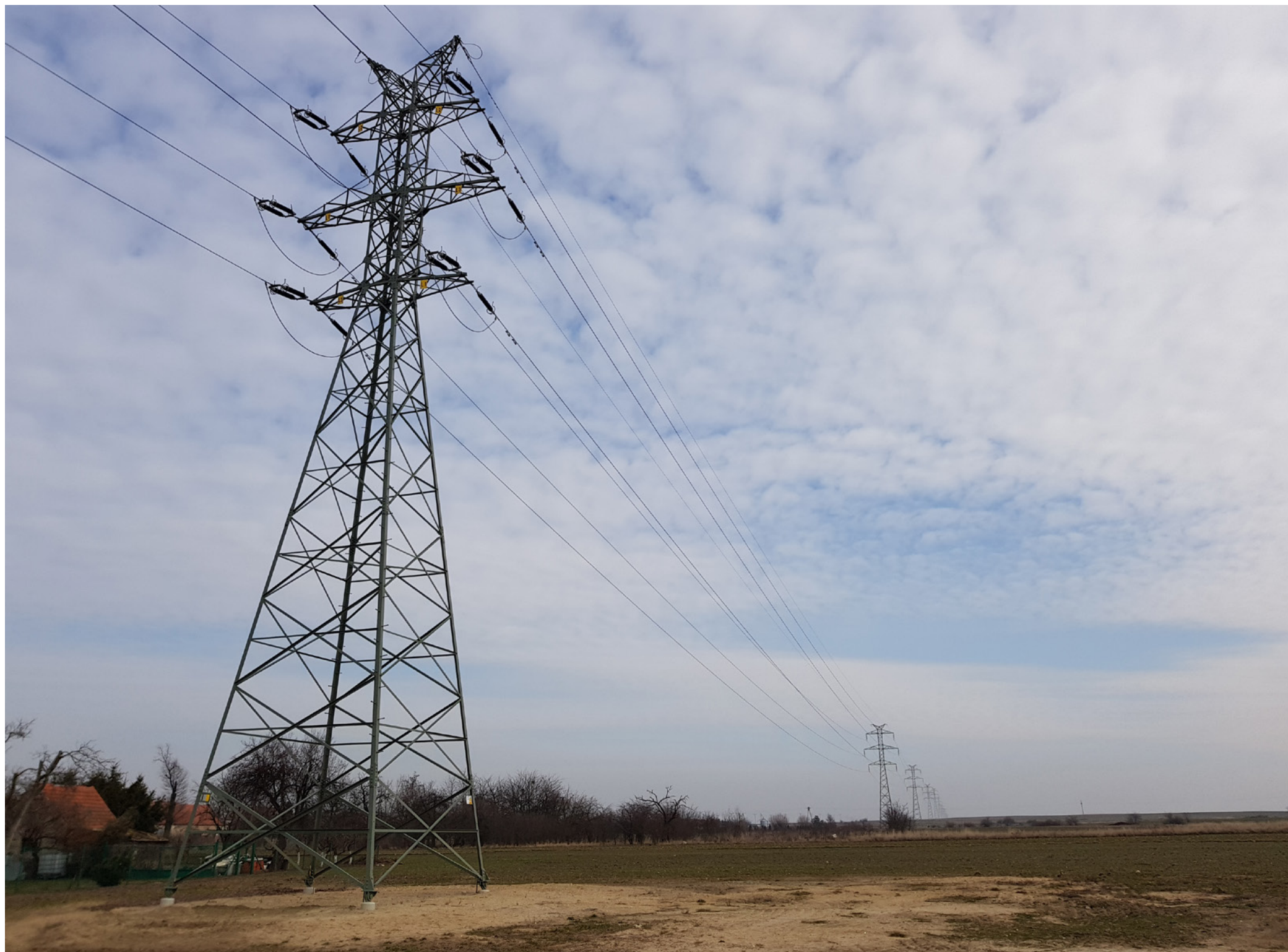
Tauron Dystrybucja, Linia 110 kV Przybków-Klecina
